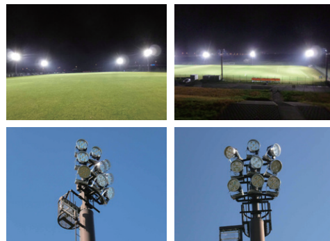
練習グラウンドに配置された照明柱
