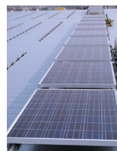
屋根の上に設置された太陽光パネル
